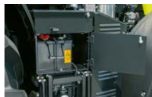
Rechts im Aufstieg befindet sich gut zugänglich die Batterie.
