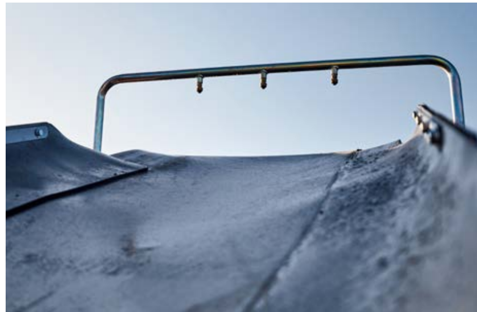
System rozpylania wody z pompą zapewniający skuteczne odpylanie.
