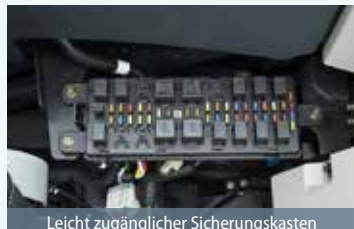
Leicht zugänglicher Sicherungskasten
